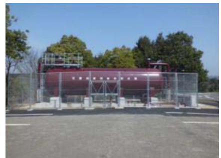
災害に備えた飲料貯水槽
