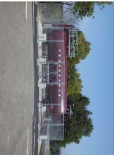
災害発生に備えた飲料貯水槽の設置
