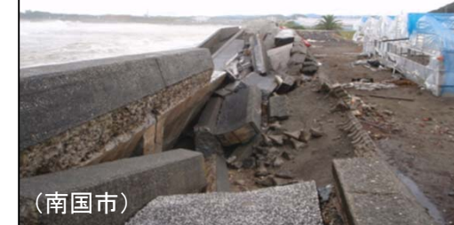
平成26年8月台風11号被災状況
