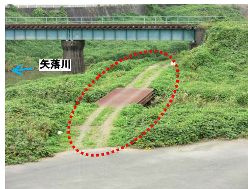
JR 矢落川橋梁付近が未舗装
