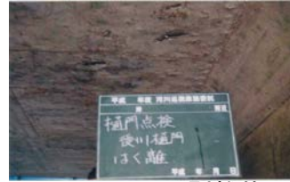
コンクリート剥離状況
