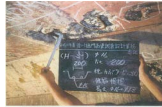
鉄筋腐食状況
