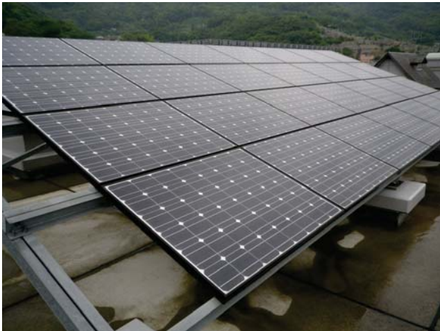
環境保全性: 太陽光発電設備
