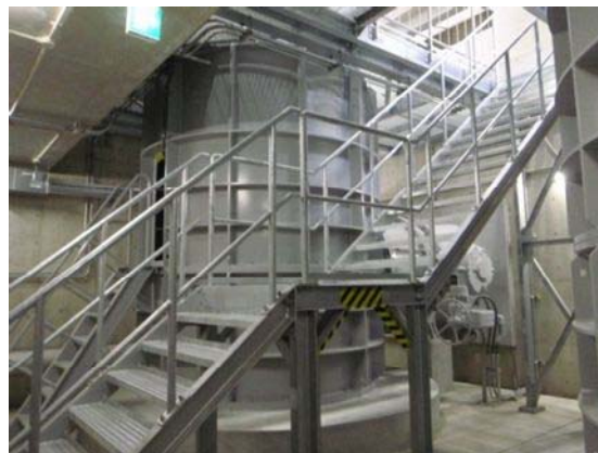
図-4.1.4 川島排水機場ポンプ設備
