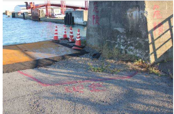
段差発生箇所
