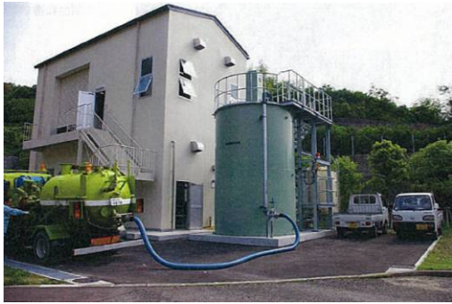
バキュームカーから貯留槽へ排出
