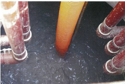
エアレーションによる攪拌
