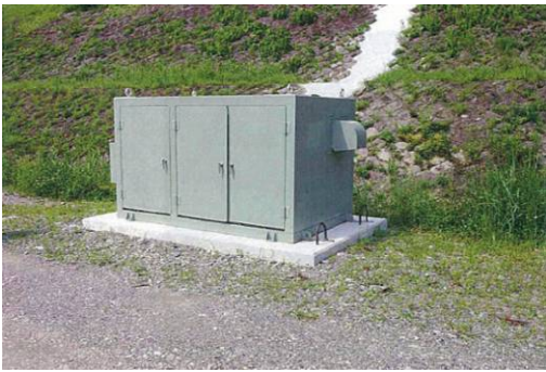
電源・送気ボックス（出水時移動）
