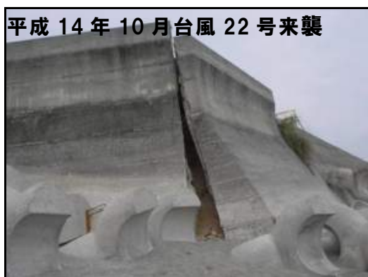
写真－2 被災状況（長浜工区）
