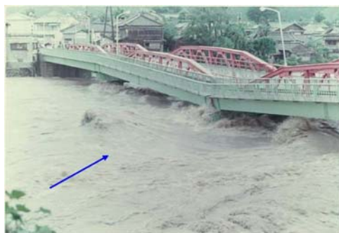
香我美橋の橋脚の被災(香美市神母ノ木地先)
