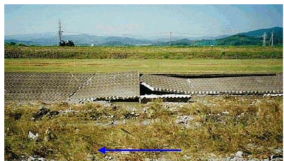
低水護岸の被災(香美市岩積地先)
