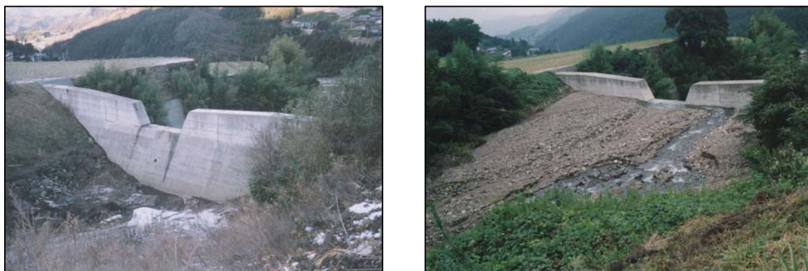
(a) 土石流発生前の白猪谷えん堤
