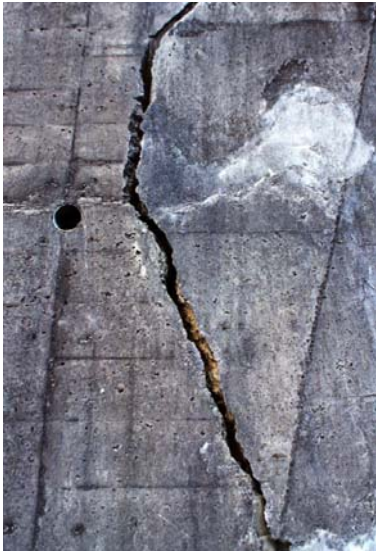
県道擁壁の被災状況
