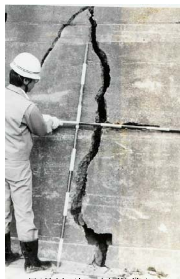
県道擁壁の被災状況
