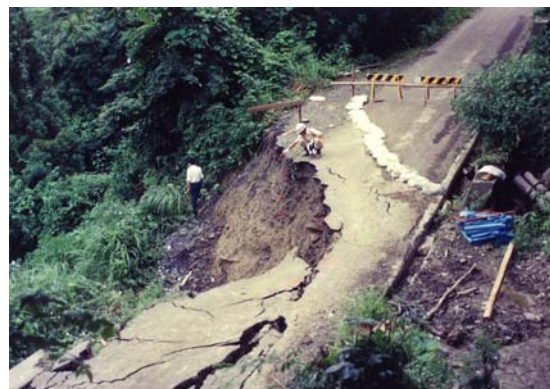
村道の被災状況
