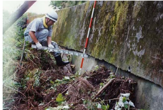
村道擁壁の被災状況
