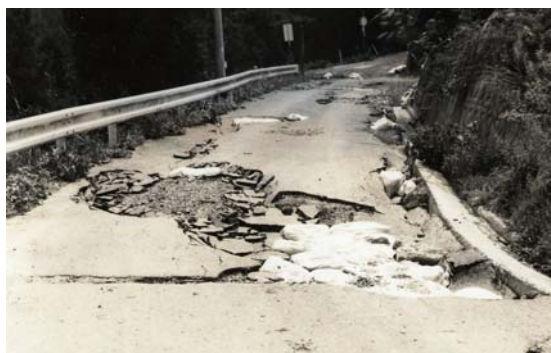
村道の被災状況
