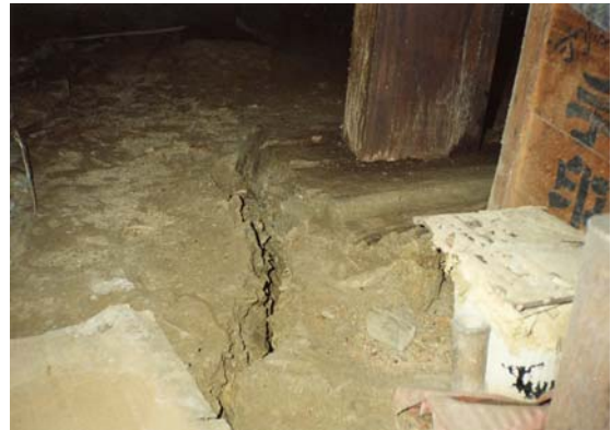
人家下のクラック状況
