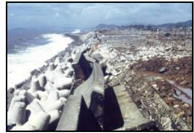
南国工区久枝地先被災状況 (昭和49年台風14,16号)
