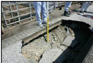
南国十市地先陥没状況 (平成17年台風14号)
