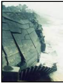
長浜工区長浜地先被災状況 (平成3年台風9号)
