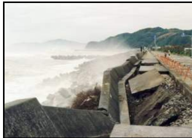
戸原工区戸原地先被災状況 (平成5年台風7号)
