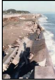
南国工区仁井田地先被災状況 (昭和54年台風16号)
