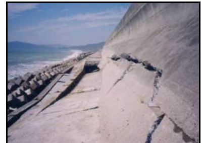
仁ノ工区被災状況 (平成13年台風11号)
