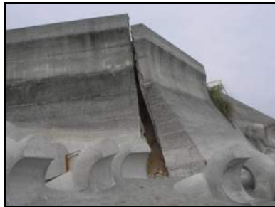
長浜工区被災状況 (平成14年台風22号)
