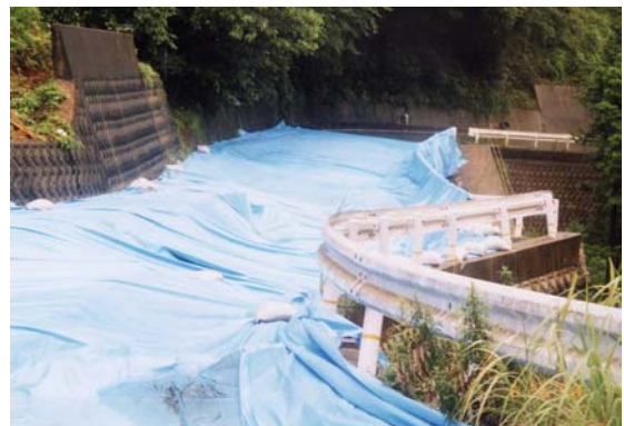
町道の被災状況
