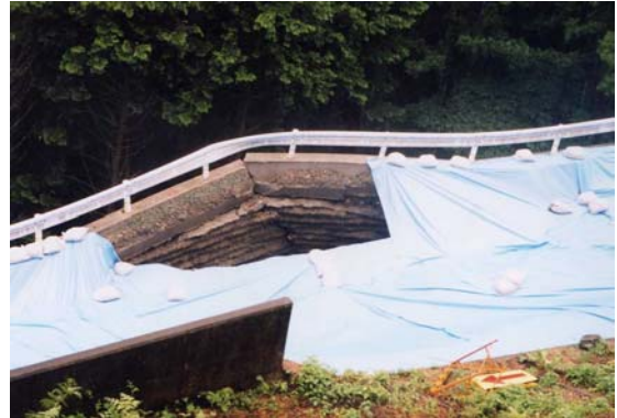
町道の被災状況
