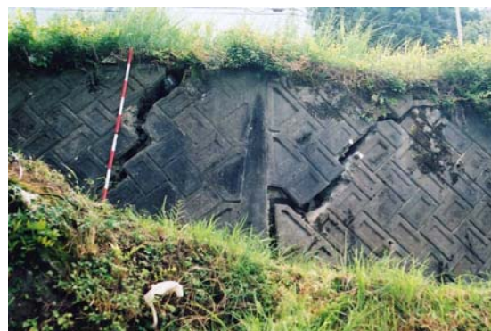
県道擁壁の被災状況
