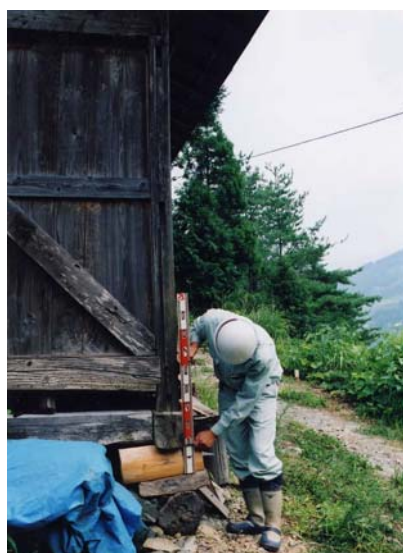
人家基礎の沈下状況
