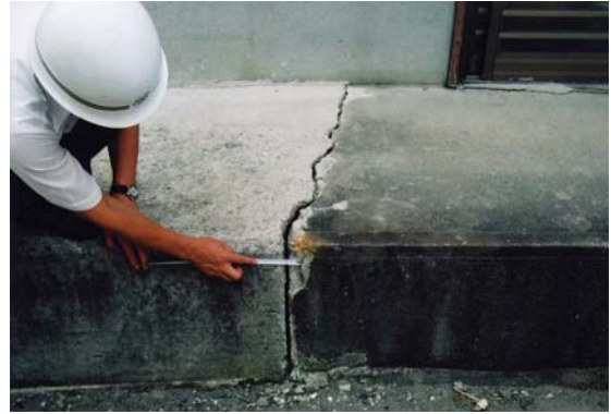
人家土間コンのクラック状況
