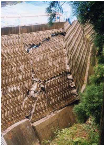
町道擁壁の被災状況
