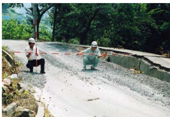
町道の陥没状況
