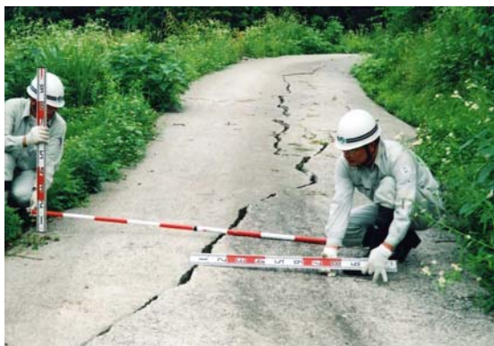
県道の被災状況
