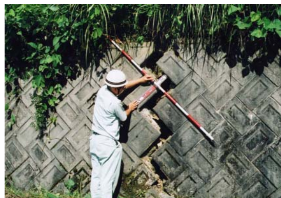
町道擁壁の被災状況
