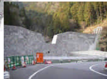
(b) 平成16年の被災状況と整備中の鈴ヶ谷えん堤
