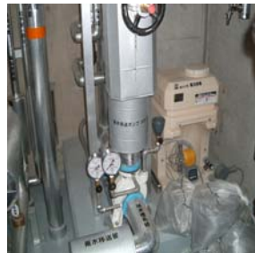
雨水利用設備 (多雨でありながら水資源不足)
