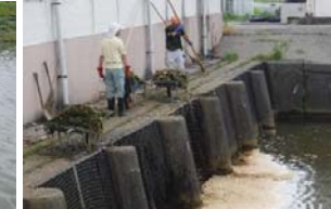
スクリーンの除塵作業
