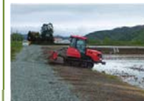
農機の旋回を容易にし、作業効率を向上させるターン農道の整備
