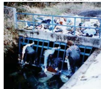
除塵機への廃棄物流入
