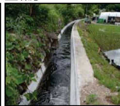
老朽化した用水路の整備・更新
