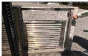
地下街の換気設備口
