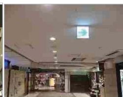
避難誘導施設の整備
