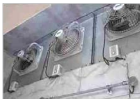
大規模換気設備
