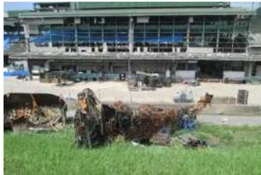
爆発した工場と高梁川の堤防に飛散した設備 （国土交通省HPより）
