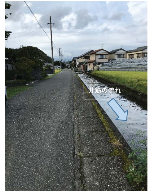
被害写真番号③（土佐市八幡地区）
