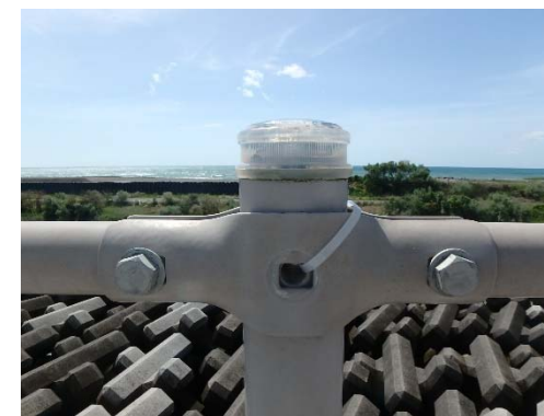
結束バンドによる応急処置状況
