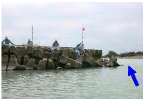
平成17年台風14号による 水制の崩落状況 (香南市吉原地先：河口より0.6km付近)
