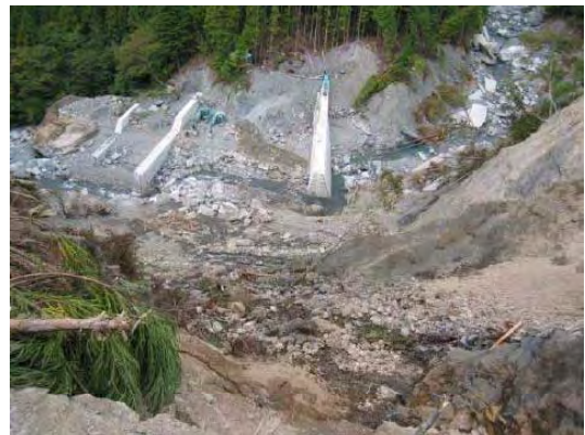
④ 治山ダムの崩壊状況
