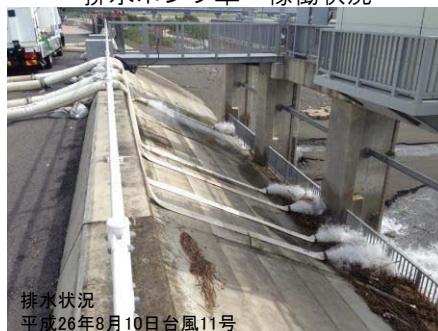
排水ポンプ車 稼働状況
