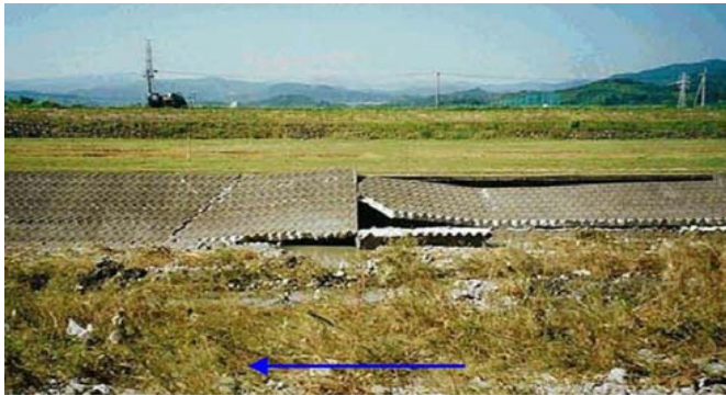
平成10年9月洪水 低水護岸の被災 右岸 香美市岩積地先:7k/8付近
