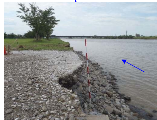
河岸の侵食 左岸 香南市深淵地先:3k/8付近
