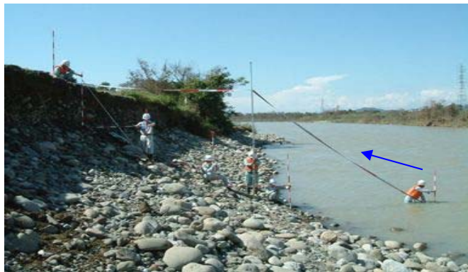
平成16年8月洪水 低水護岸の被災 左岸 香南市深淵地先:4k/8付近
