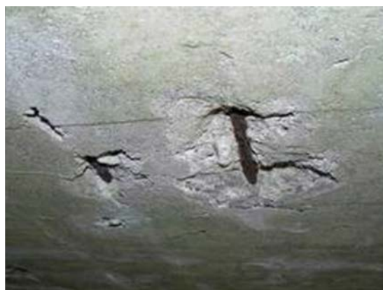
【管渠内鉄筋露出状況】
