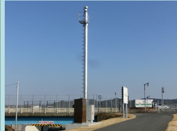
弘岡CCTVカメラ
