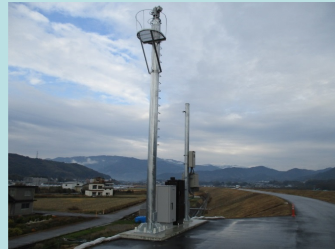
下ノ村CCTVカメラ
