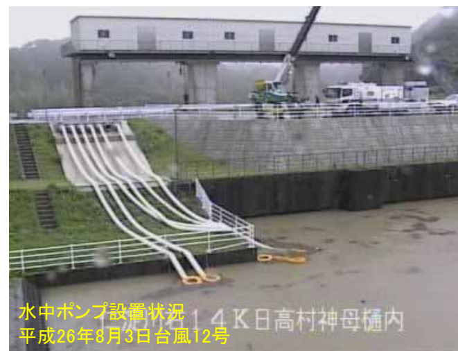
排水ポンプ車 稼働状況
