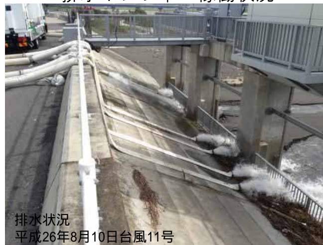
排水ポンプ車 稼働状況
