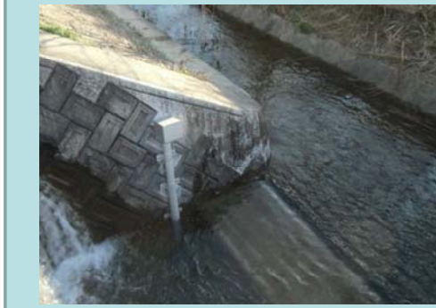
田ノ裏水位計センサー部
