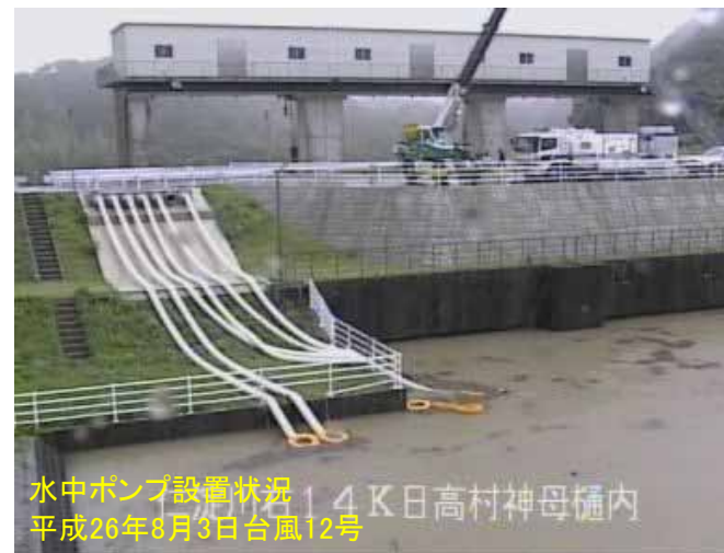
排水ポンプ車 稼働状況
