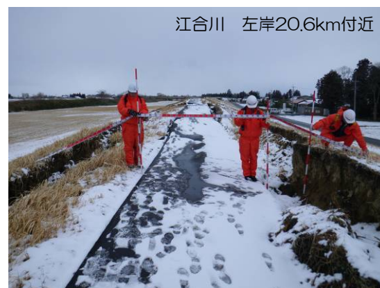
雪の中での調査（堤防の沈下）
