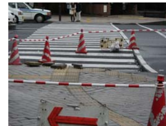
路面陥没状況
