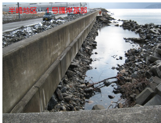
半崎地区 1号護岸基部 被覆ブロックの散乱、基礎材の崩れが発生
