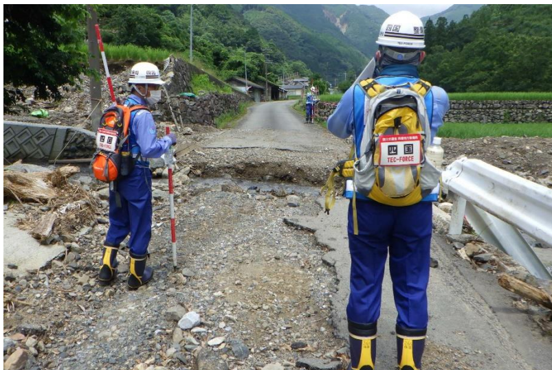
【球磨郡球磨村:被災状況調査(道路班)】
