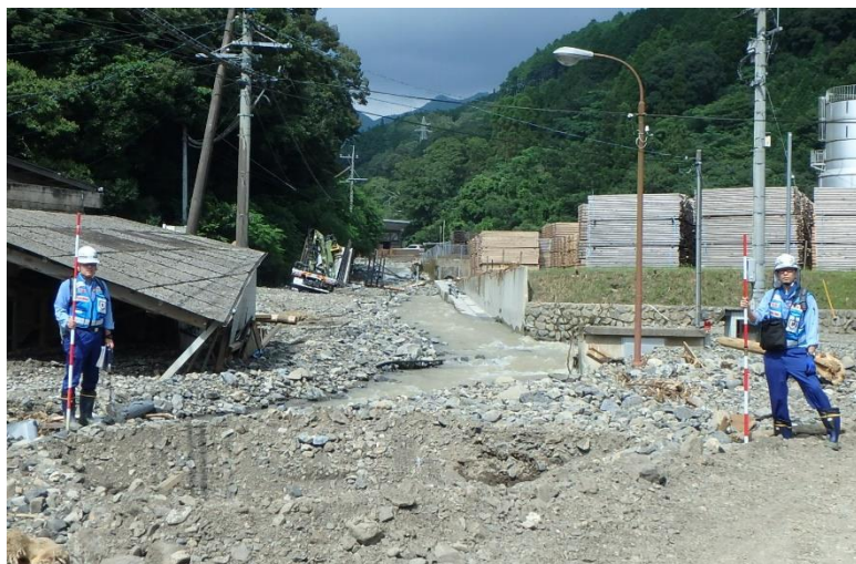
【球磨郡球磨村:被災状況調査(砂防班)】
