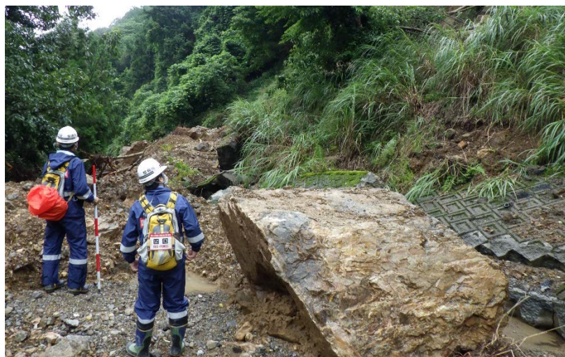
【球磨郡球磨村:被災状況調査(道路班)】
