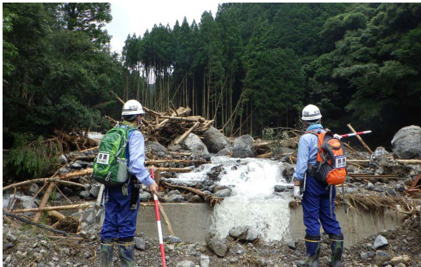
【八代市:被災状況調査(河川班・砂防班)】
