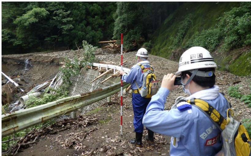
【八代市:被災状況調査(道路班)】
