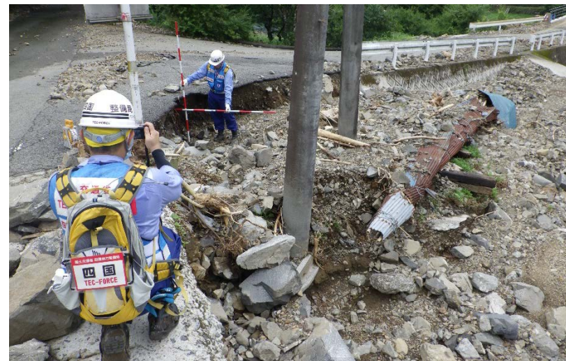
【球磨郡球磨村:被災状況調査(道路班)】
