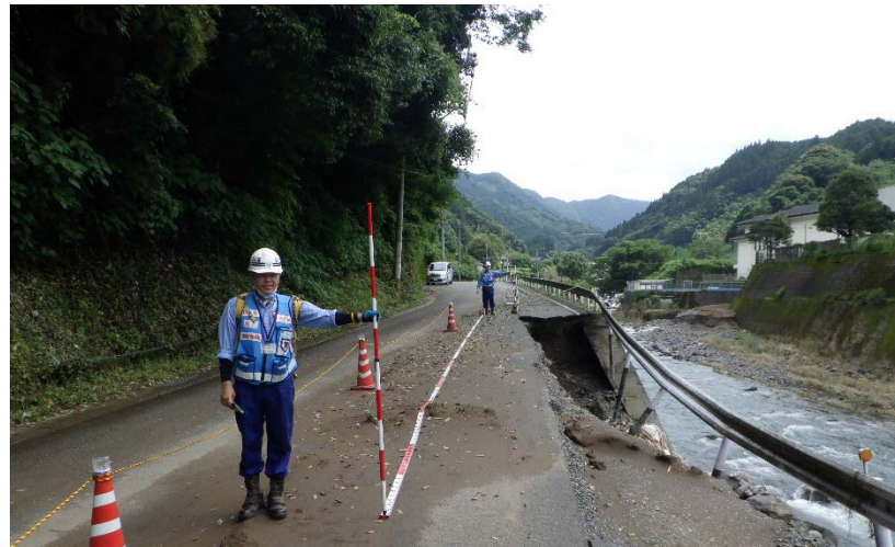
【球磨郡球磨村:被災状況調査(道路班)】
