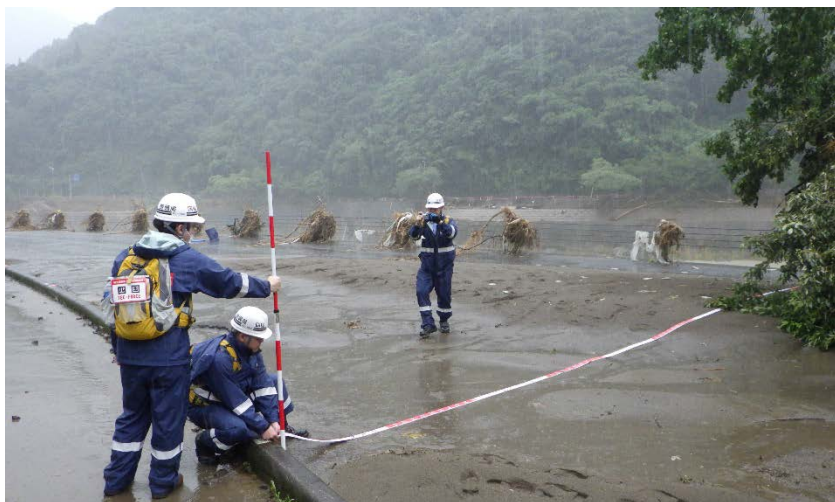
【球磨郡球磨村:被災状況調査(道路班)】
