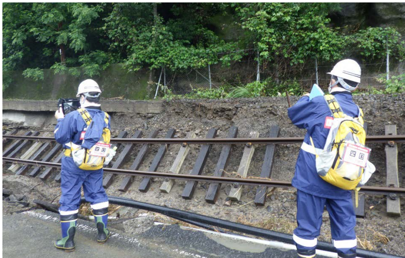
【八代市:被災状況調査(河川班・砂防班・道路班)】
