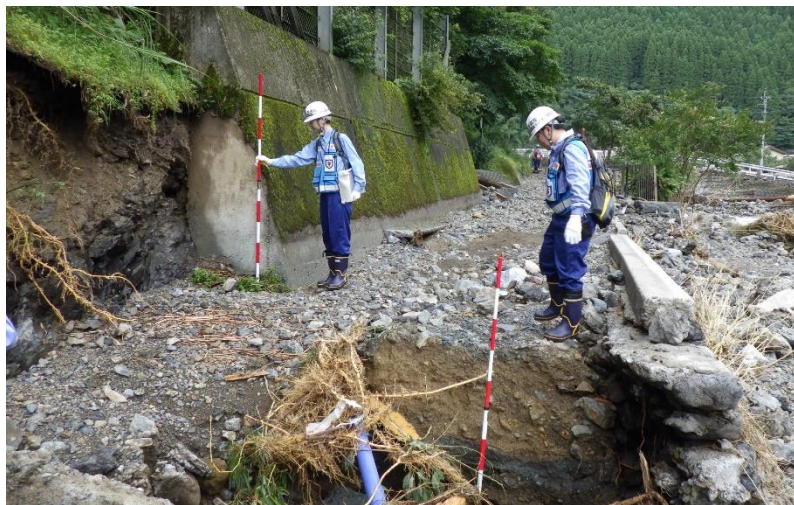
【八代市:被災状況調査(道路班)】
