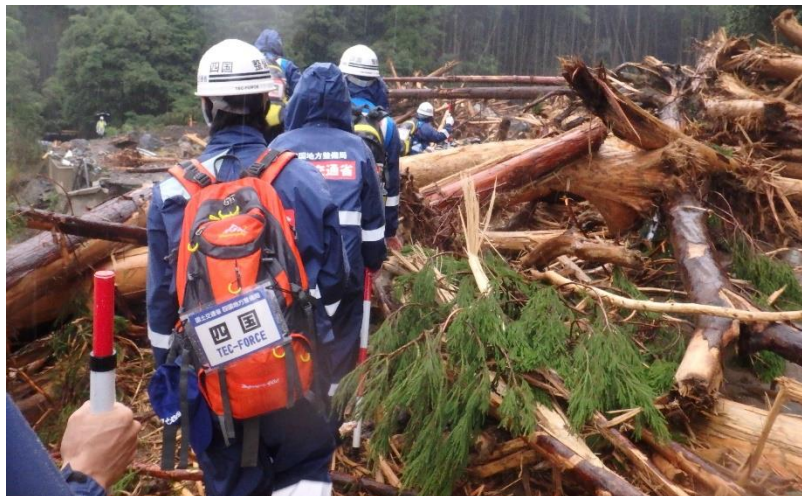
【八代市:被災状況調査(河川班)】
