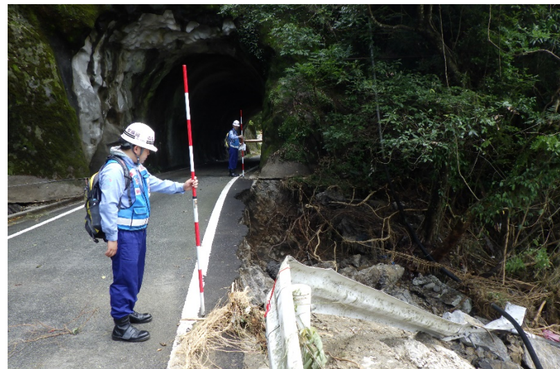
【八代市:被災状況調査】
