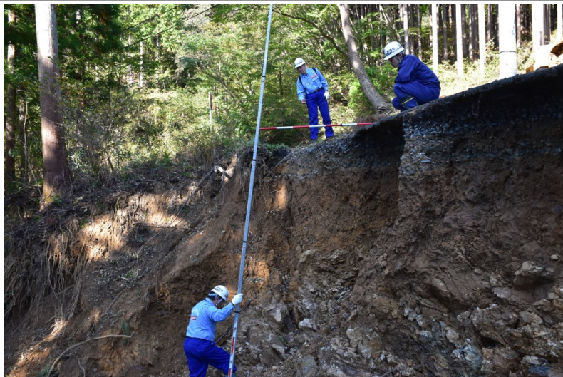
【埼玉県比企郡ときがわ町:被災状況調査】
