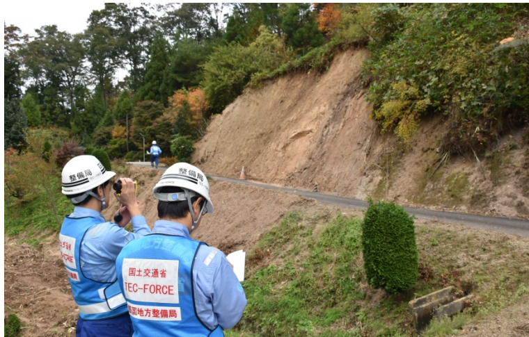
【福島県いわき市:被災状況調査】
