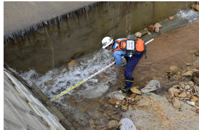
【福島県双葉郡川内村:被災状況調査】
