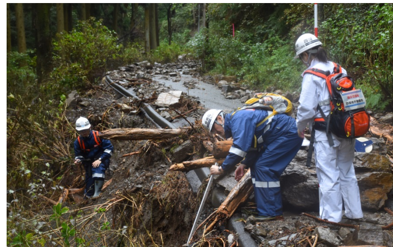
【埼玉県本庄市: 被災状況調査】
