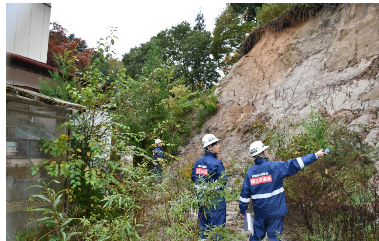
【福島県いわき市:被災状況調査】
