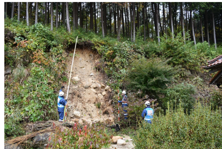
【福島県双葉郡川内村:被災状況調査】
