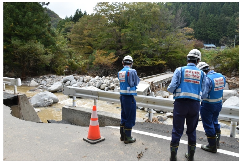
【福島県南相馬市：被災状況調査】
