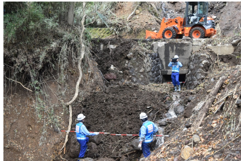
【神奈川県足柄下郡箱根町:被災状況調査】
