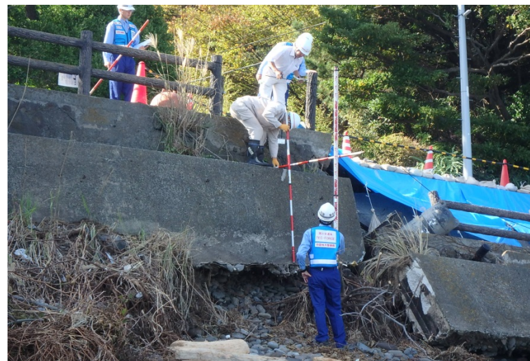
【神奈川県足柄下郡真鶴町:被災状況調査】
