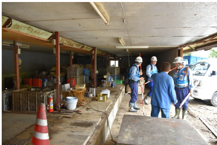
【長野県上田市：被災状況調査】
