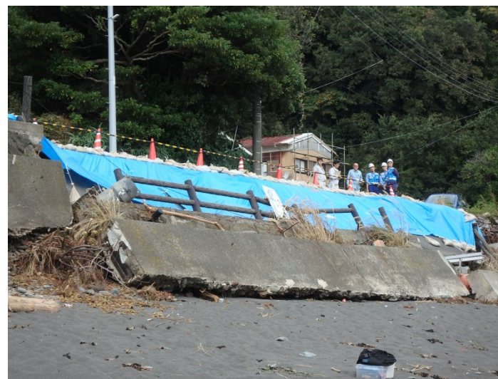
【神奈川県足柄下郡真鶴町:被災状況調査】
