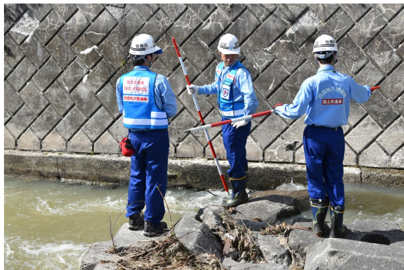
【長野県上田市: 被災状況調査】
